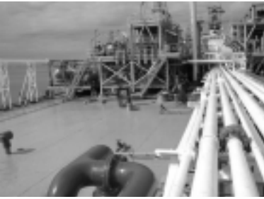
Plateforme de production pétrolière
